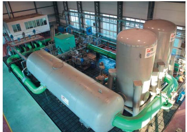
14 MW test stand
