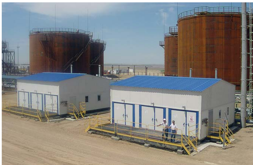
Фото 3. Насосная перекачивающая станция (НПС)
