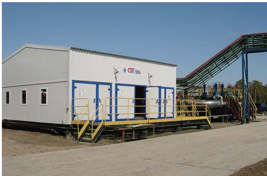
Фото 2. Станция насосная блочная мультифазная (БМНС)
