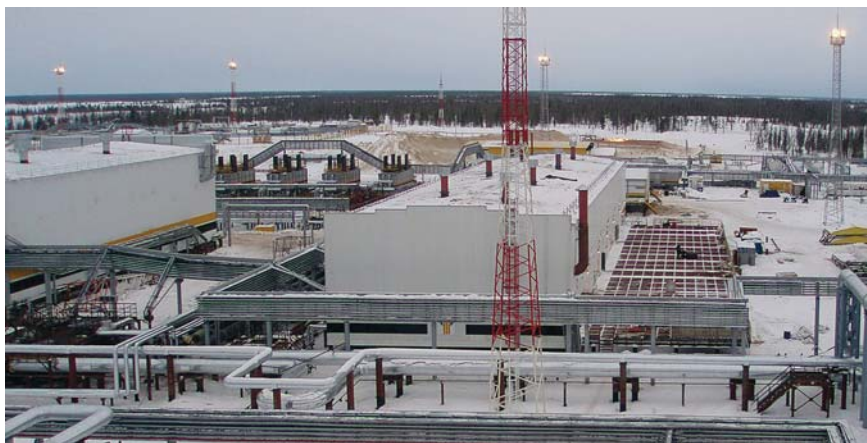
Фото 4. Насосная перекачивающая станция НПС 2 на Ванкорском месторождении ЗАО «Ванкорнефть», НК «Роснефть»
